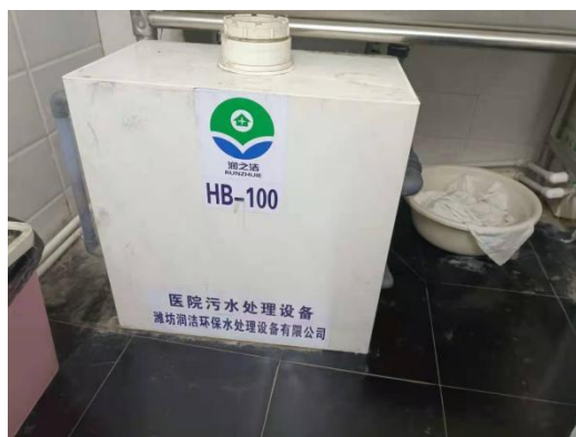
污水处理设施
